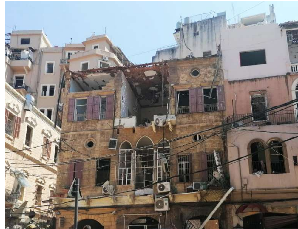
Photographie de Beyrouth après l'explosion du port du 4 août 2020 – Bâtiments dépouillés de leurs Fenêtres et par conséquent, l'Architecture perd sa fonction, la vie sociale s'éteint et la ville perd son âme.
